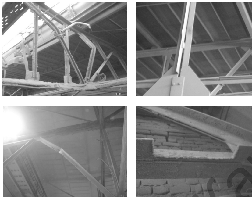
Рисунок 1. Дефекты стальной стропильной фермы
